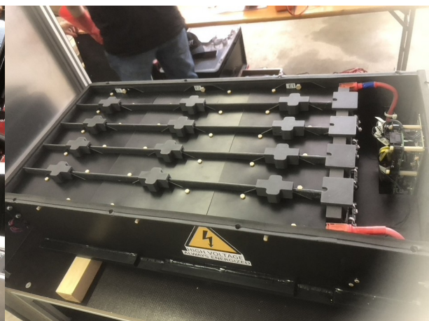
Inspection sur l'accumulateur ouvert de la Haute école spécialisée bernoise.
